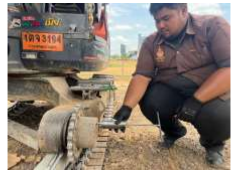
ภาพที่ 6 ทดลองใช้อุปกรณ์ถอดฝามอเตอร์ตัวเดินรถขุดรุ่น KX
